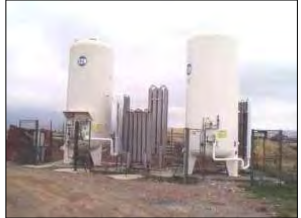
Serbatoi di ossigeno liquido
